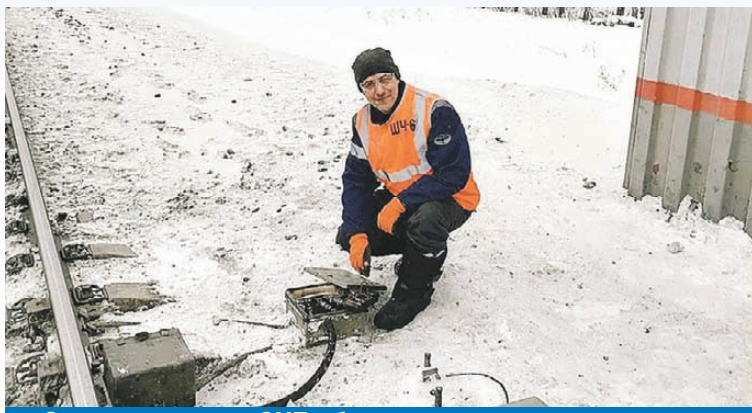
Электромеханик СЦБ обслуживает железнодорожную аппаратуру: стрелки, переезды, светофоры.
